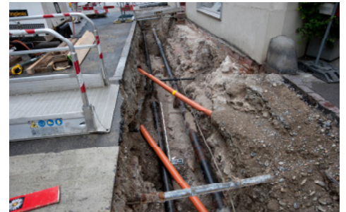
Die Fundamente des Hauses Spalenberg 64 stehen auf den mächtigen Turmfundamenten und die Leitungen führen darüber hinweg.
