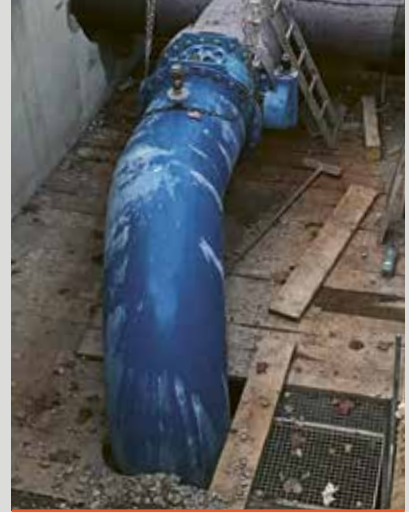
Die Transportwasserleitung hat einen Durchmesser von einem Meter.
